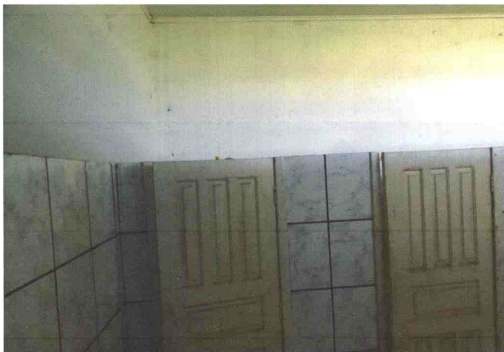
Figura 3: vista interna banheiro, detalhe porta do sanitário.
